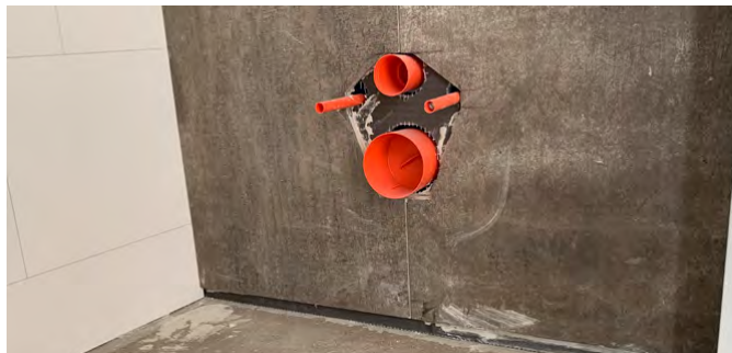
toilet aansluiting op riool
