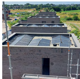
plat dak met PV panelen
